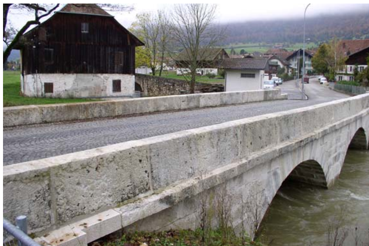
Nach der Restauration: Schrägansicht von der Unterwasserseite. Im Hintergrund links eine ehemalige Mühle. Abb. 3 (GS, 27. 10. 2004)
