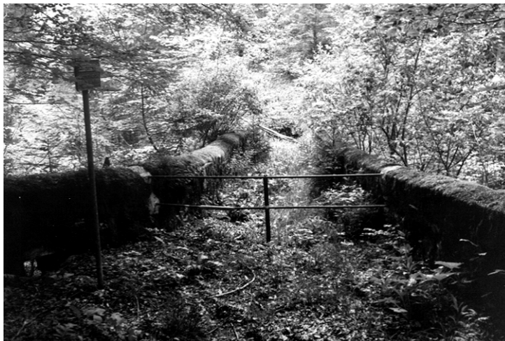
En 1990: vue de l'état misérable du pont menaçant de s'effondrer, recolonisé par la végétation et interdit aux piétons, prise depuis la rive droite (depuis Montbovon) Fig. 2 (JPD, 22. 5. 1990)
