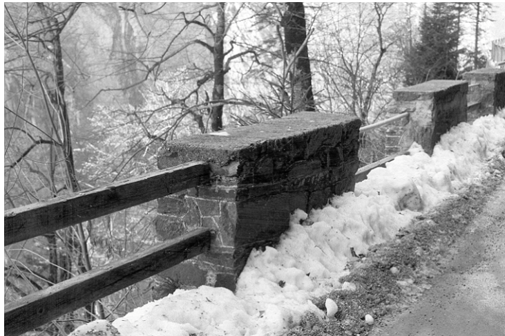
Die die Brüstungsmauern verbindenden Holzholmen sind z.T. durch Metallrohre ersetzt worden. Abb. 7 (Heg, 23. 1. 1989)
