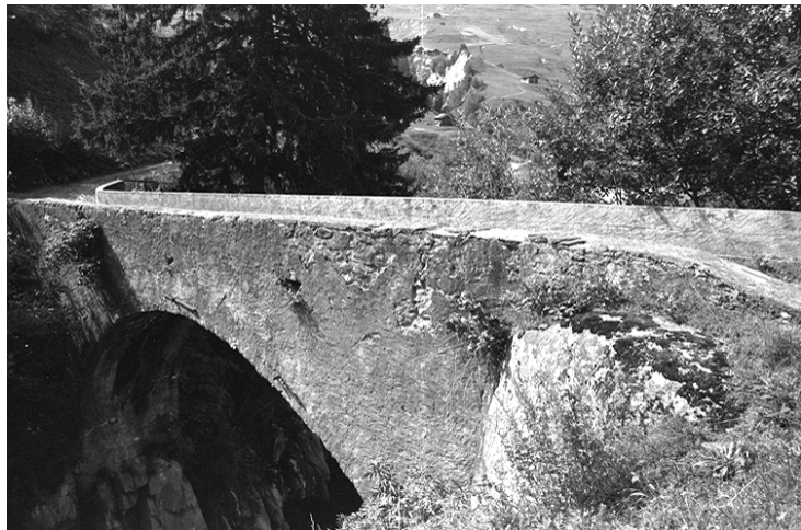
Der Verputz der eleganten «Römerbrücke» blättert langsam ab und sollte gelegentlich ersetzt werden. Das rechte Widerlager ist geschickt mit einem natürlichen Felskopf verbunden. Abb. 1 (Heg, 22. 8. 1994)
