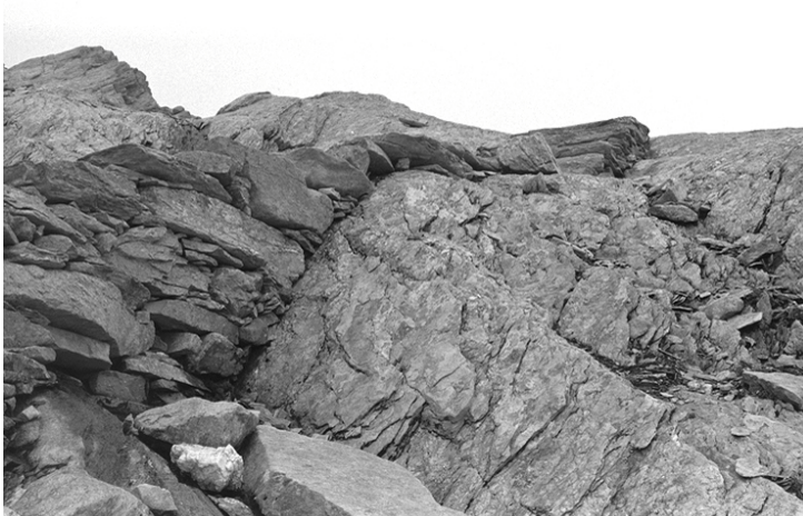
Die unregelmässig-lagig geschichtete Stützmauer schmiegt sich förmlich an den Felsen. Abb. 10 (Heg, 10. 8. 1989)
