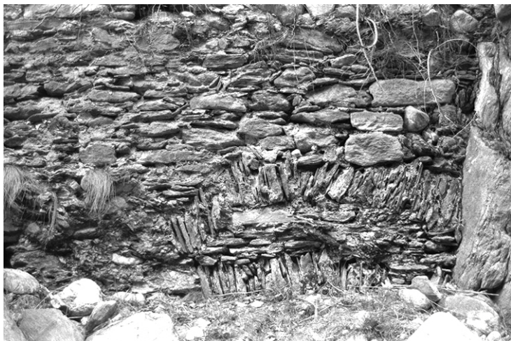
Dettaglio del muro. La base che lo sostiene, di fattura diversa, potrebbe essere un residuo della mulattiera urana sulla quale è stata costruita la strada cantonale. Fig. 5 (Be, 2. 5. 1994)
