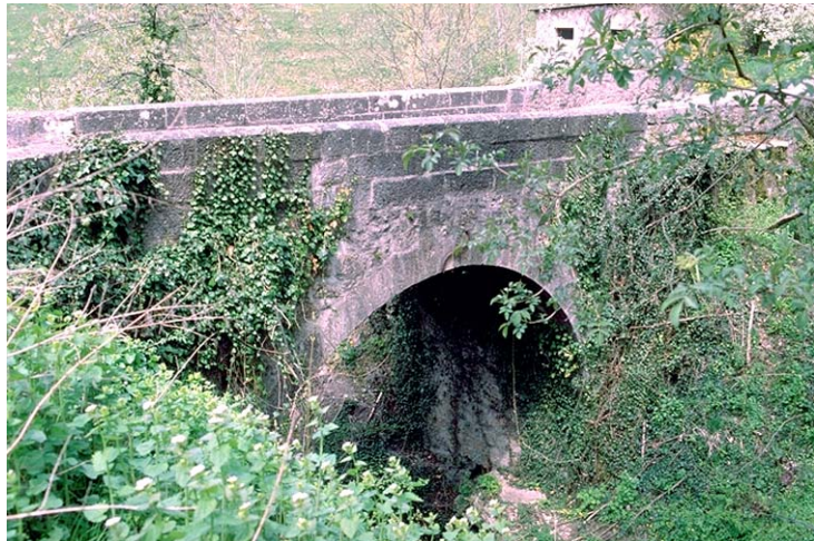
Les Clées: pont à une arche de pierre sur l'Orbe Fig. 5 (nab, 3. 3. 2002)
