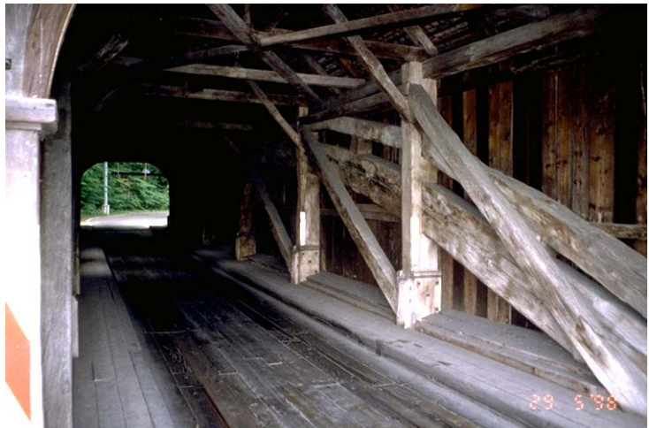
Im Innern der Brücke wird Grubenmanns Stabbogenkonstruktion von einem Fachwerk überlagert, welches das Tragwerk versteift. Blickrichtung Nordwest. Abb. 3 (do, 29. 5. 1998)
